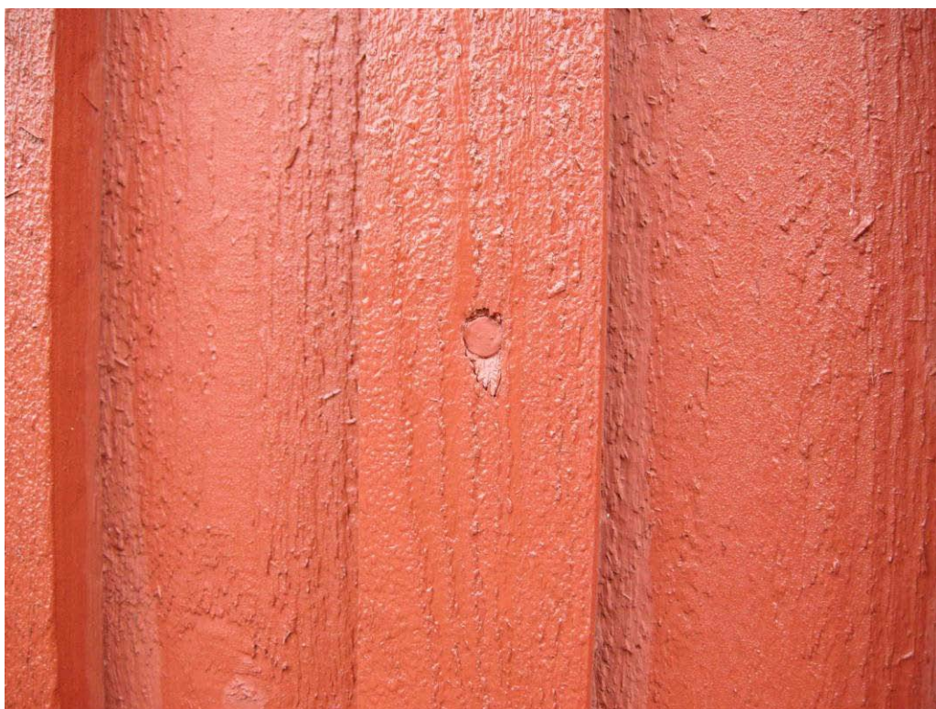
Figur 26 Grunt spikhål, men tydlig skada på panelytan.
