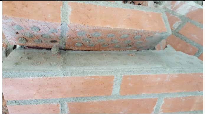
Bild 22. Närbild på den liggfog där brottet sker.
