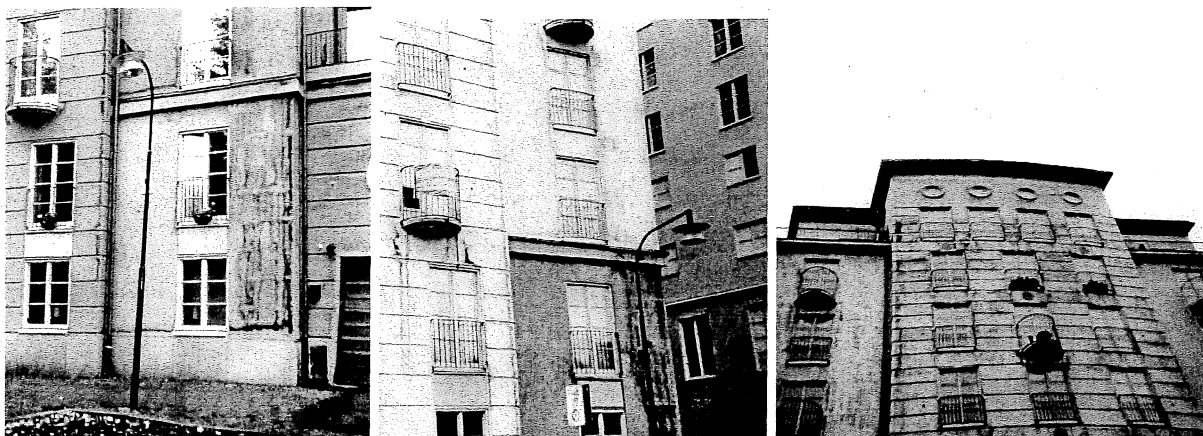
FIGUR 8. Påväxt på en ny fasad i Stockholm.
