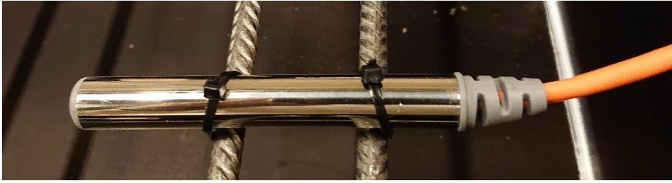
Figur 3.2 Sensohives fuktsensor monterad på två armeringsjärn.
